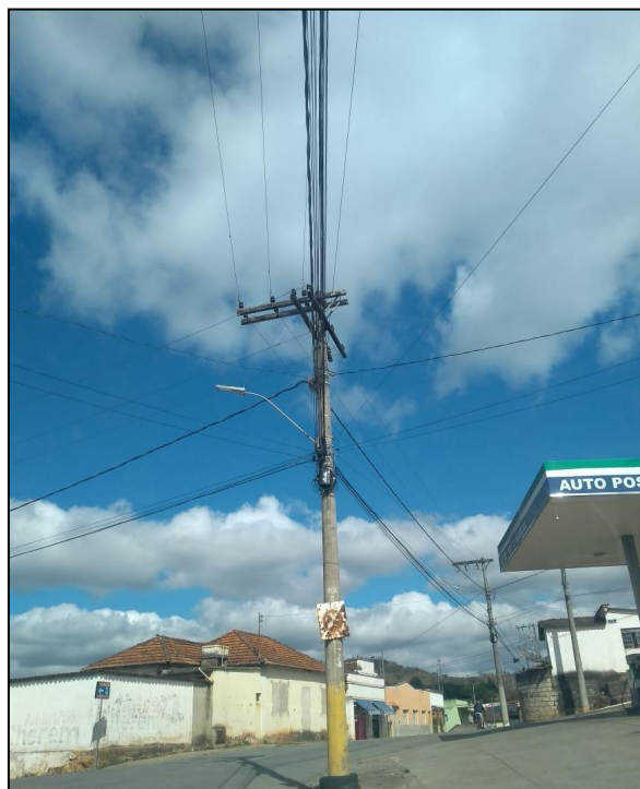
Figura 71 - Rede de energia elétrica.
