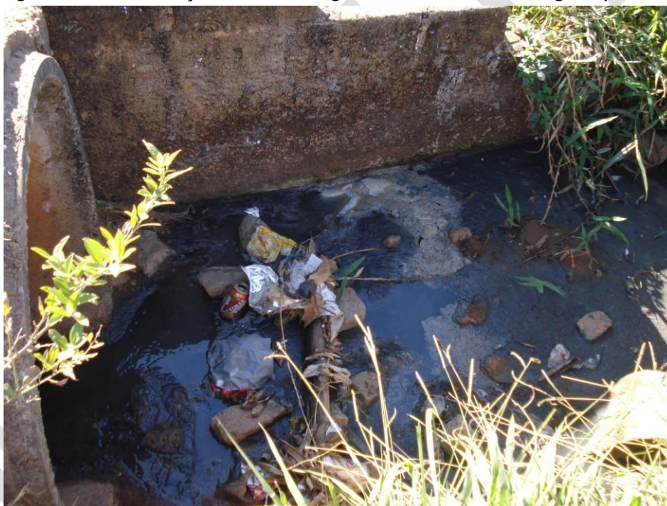
Figura 30 - Presença de lixo e esgoto na rede de drenagem pluvial.
